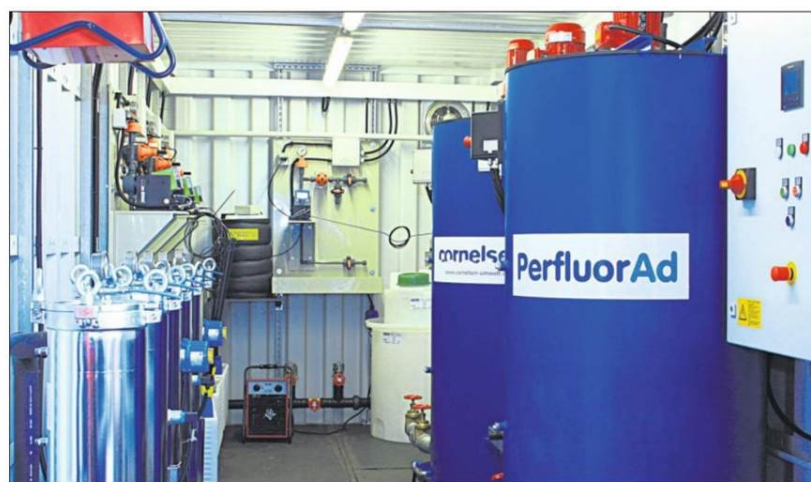
FÜR PFC-BELASTETES GRUNDWASSER sind wie hier im Beispiel der Firma Cornelsen, die bereits erfolgreich PFC-Sanierungen vornimmt, spezielle Wasserreinigungsanlagen entwickelt worden.
